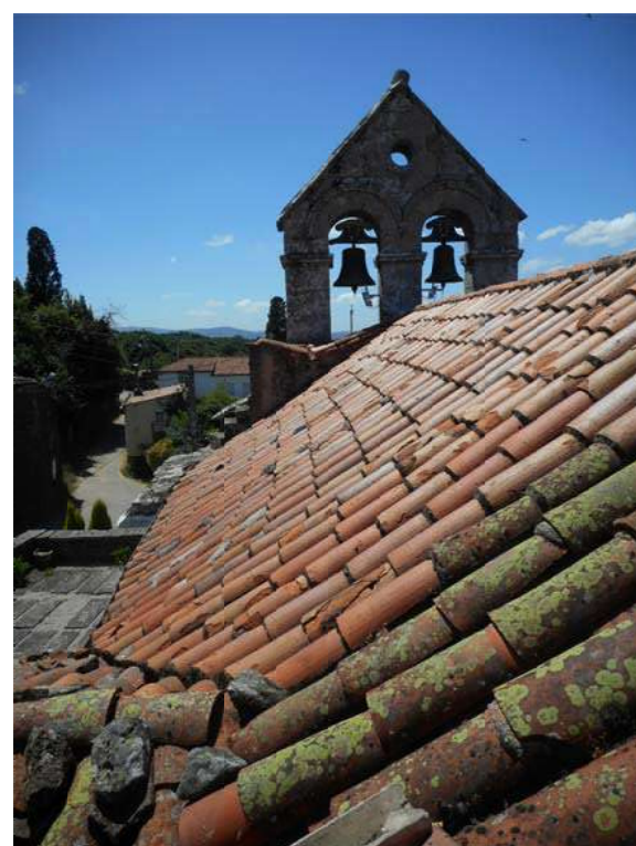
Patoloxía: Pendente excesiva da cuberta
